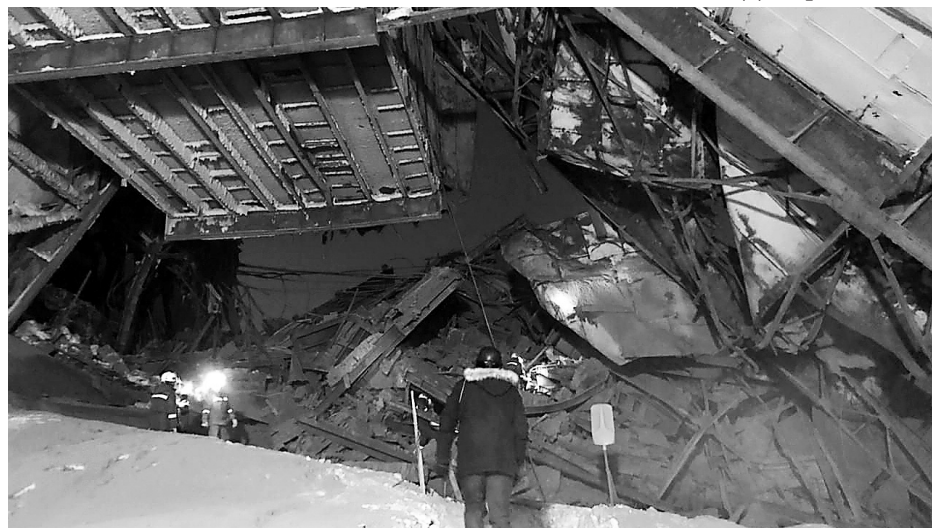
Причины обрушения строительных конструкций выясняются
